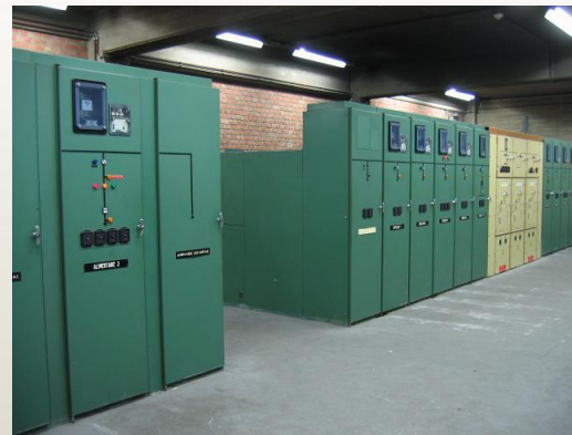
Anlage unter Spannung 6.3 kV
