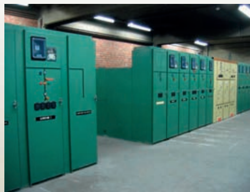
Urządzenia pod napięciem 6,3 kV
