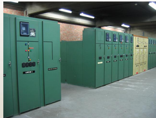
Equipements sous-tension 6.3 kV
